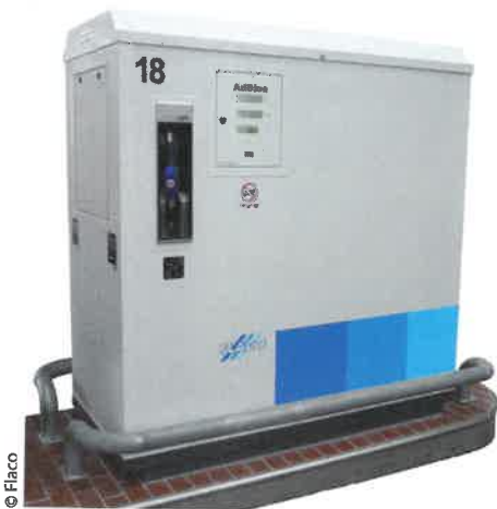
Der integrierte AdBlue-Tank bei Flaco fasst 1.100 Liter.
